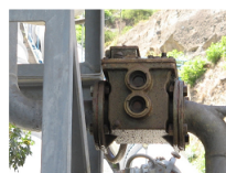
Vista del Relé Buchholz
